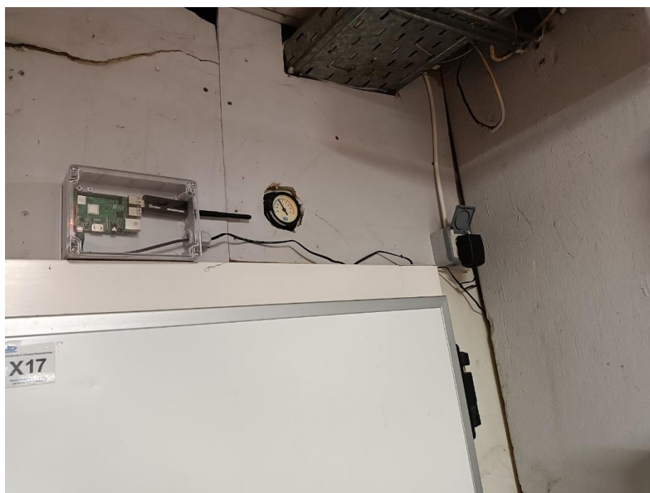
Εικόνα 2.14 Κόμβος διαδικτυακής πύλης τοποθετημένος στους αποθηκευτικούς χώρους του καταστήματος της Μασούτης ΑΕ
