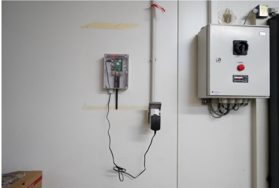
Εικόνα 2.15 Κόμβος διαδικτυακής πύλης τοποθετημένος στις αποθήκες του καταστήματος της Μασούτης ΑΕ
